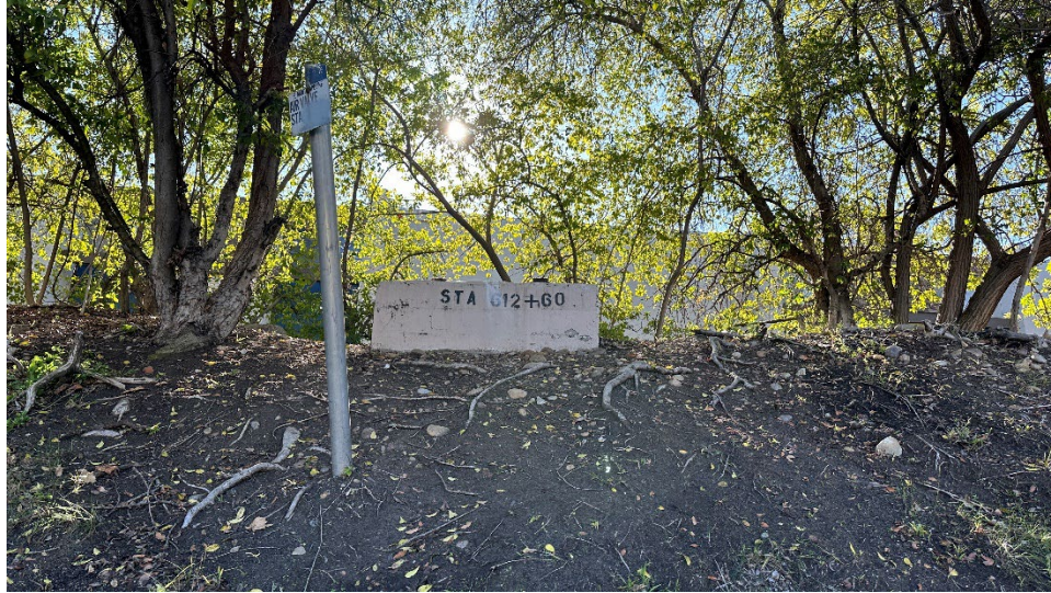
Figure 19. 612+60, Overview of AV Valve, facing south.
